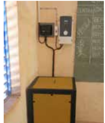
Coffre de protection de batterie, Pissila, Burkina Faso.
