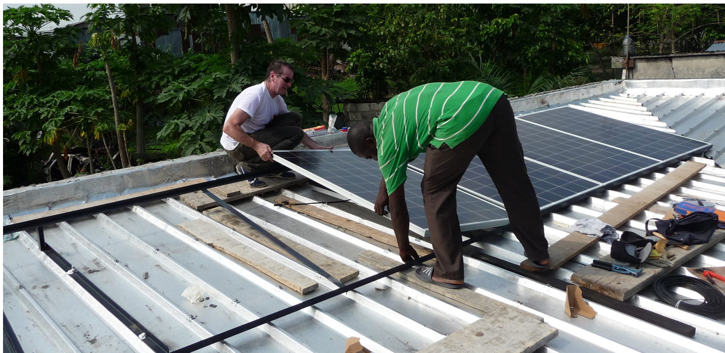
Centre de santé de Voka et Moukondo (Congo Brazzaville) soutenu par le Syndicat Départemental d'Énergie Électrique de la Gironde
